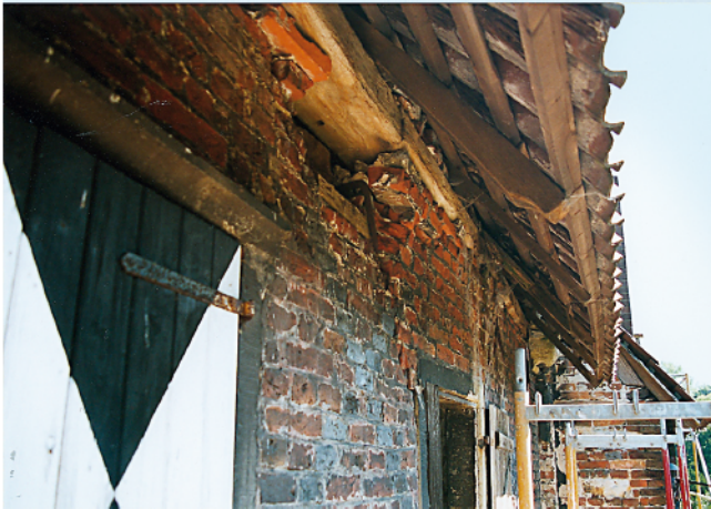
Abb. 13. Die Setzung und Verschiebung der Mauerlatte im Nordwesten des Hauses hat auch große Teile der Mauerkrone zerstört.
