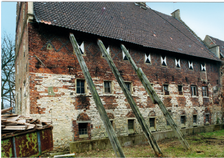
Abb. 7. (oben) Westfassade; Zustand vor Beginn der Arbeiten.
