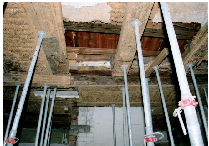
Abb. 15. Stark zerstörte Balkendecke nach der Freilegung 2008.
