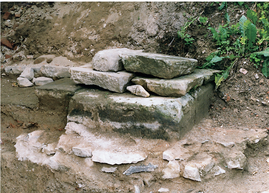
Abb. 8. Burgruine Tharandt, freigelegte spätgotische Pfeilerbasis auf der Nordwand des Südturmes von Südosten. Diese im Text beschriebene Wand ist als Südwand eines möglichen Küchengebäudes ältester Bauteil der Oberburg (Foto: Verf., 30. 06. 97).
