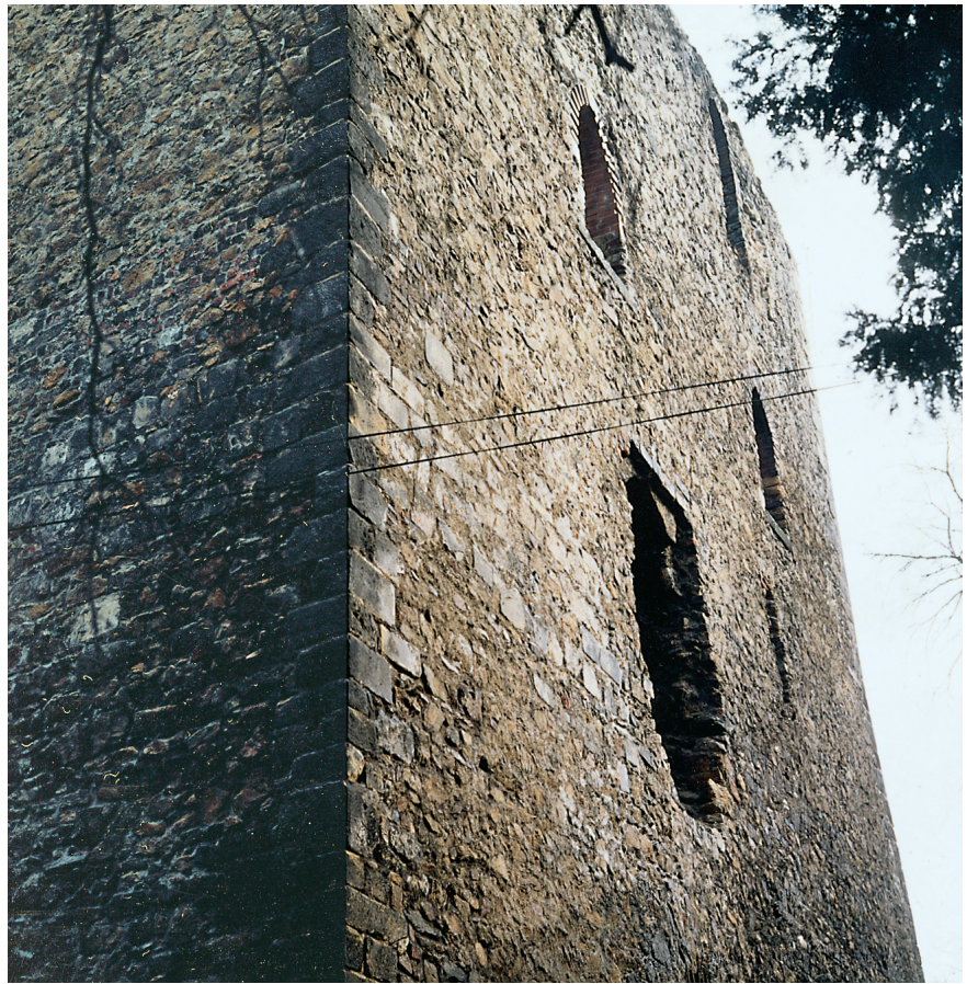
Abb. 6. Torhauswestwand der Burgruine Tharandt von Nordwesten. In Bildmitte das spätgotische Portal mit dem Falz für die Zugbrücke, das Mauerwerk links neben dem Portal enthält zahlreiche Spolien (Foto: Verf., 14. 01. 94).
