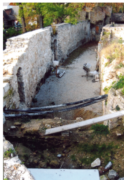
Schkölen, Saale-Holzland-Kreis. Zwinger der Westseite: Diskrepanz zwischen Ergänzung (links) und Verfall (rechts) zweier Mauerzüge (Foto: Verf., Okt. 2006).
