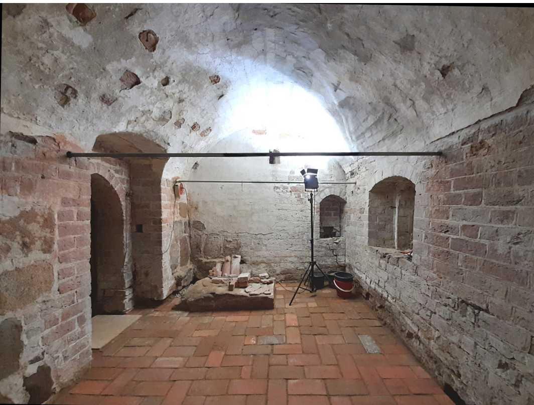
20 Die hergerichtete Gruft in der Dorfkirche St. Georg, Lüdershagen, mit einem trockenen Backsteinboden und einer funktionierender Belüftung
