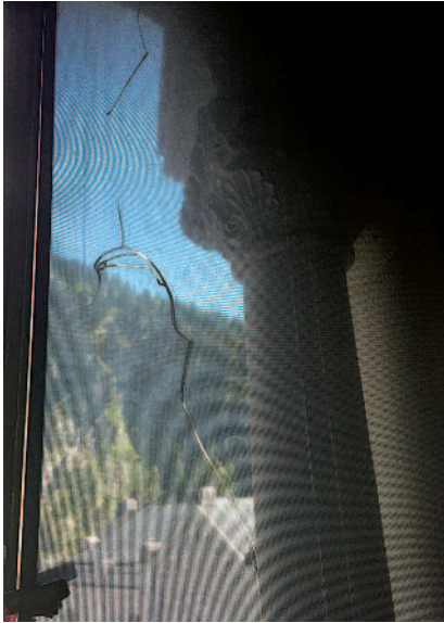
6 Schloss Neuschwanstein, Palas, Wohnzimmer, Kastenfenster mit Aufdoppelung einer dunkel getönten Acrylglas­scheibe. Ausdehnung und Erwärmung des Acryl­glases führten zu Spannungen im Material und zu einem Sprung in der historischen Glasscheibe.
