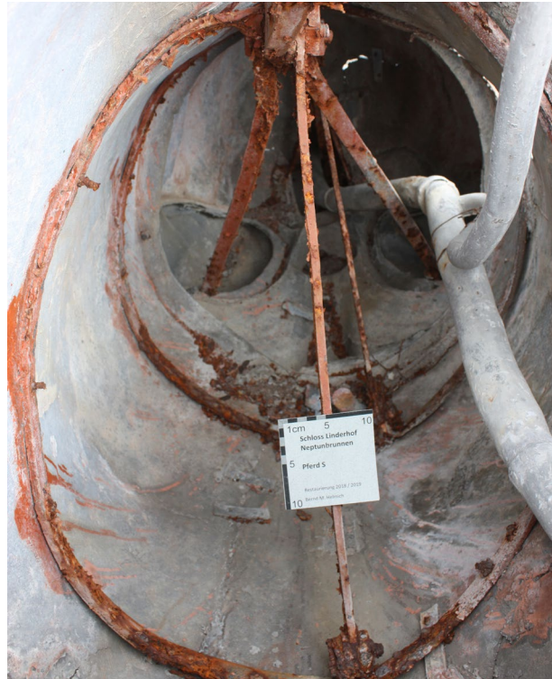
2 Das historische, schmiedeeiserne Innengestell im Pferd Süd mit den Bleileitungen für das Wasserspiel
