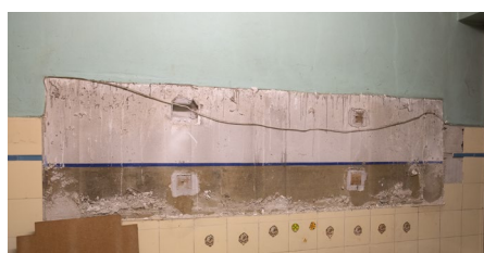
23 Freigelegte Wandfläche (Norden) nach Abnahme des Oberschranks in der Küche, Raum 1.2, mit Sicht auf die vermeintliche Erstfassung in Leimfarbentechnik und Gliederung in Unter- und Oberwandbereich
