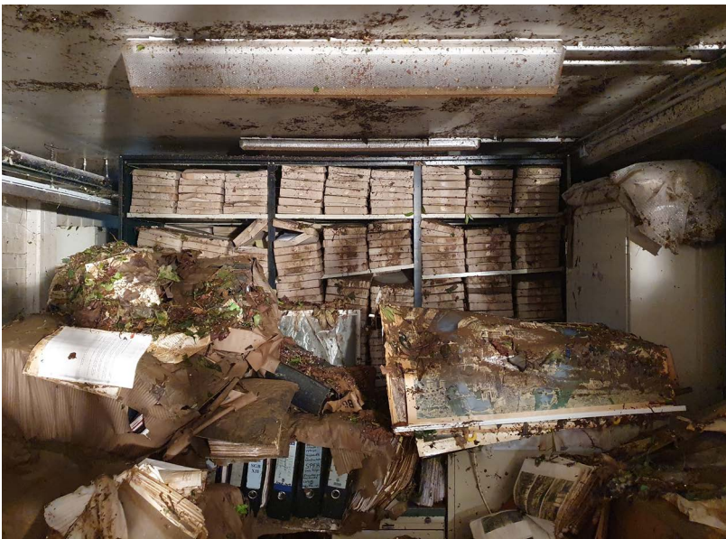
2 Magazinraum nach dem Hochwasser
