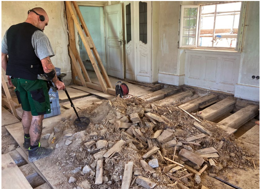
Abb.2: Auf der Suche nach Funden in Fehlböden Das Denkmalamt untersuchte die Fehlbodenschüttungen optisch und mit Metallsuchgeräten. Foto: E. Sichert, Denkmalamt FFM
