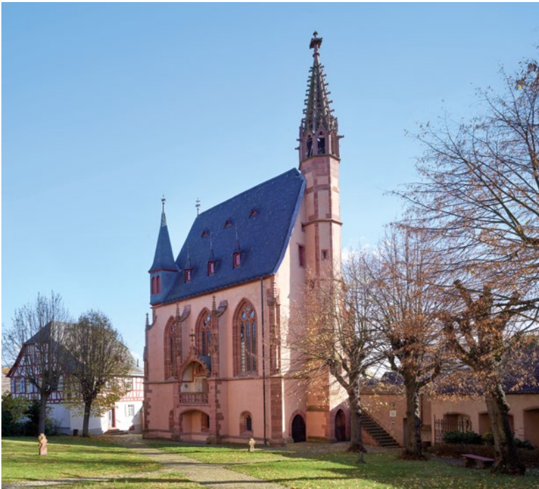
Abb. 1: Michaelskapelle Kiedrich nach der Restaurierung 2021, Außenansicht vom Kirchhof aus Foto: M. Schawe, Frankfurt
