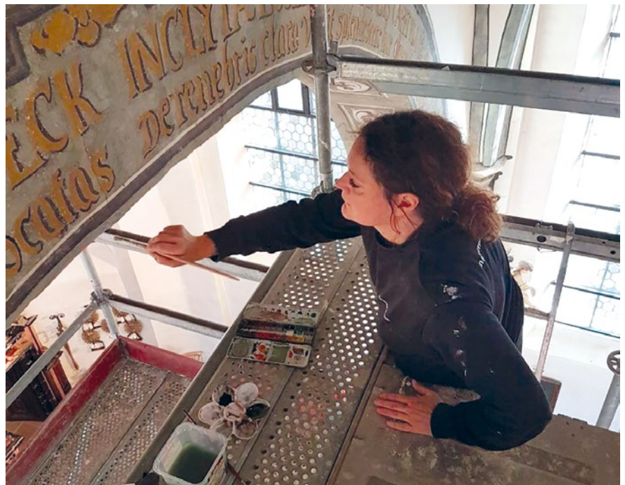
Restaurierungsarbeiten in der Kirche St. Johannes der Täufer Fulda Foto: M. Vogel-Schmidt
