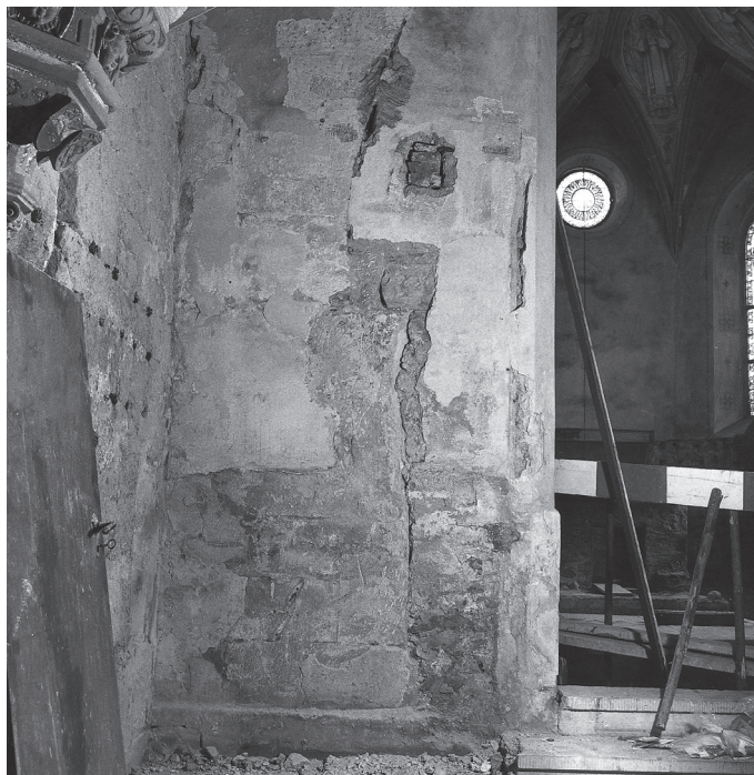
Abb. 24 Starzach-Wachendorf, Kirche SS Peter & Paul. Nördliche Pfeilervorlage des Triumphbogens der Bauphase VIa mit Ansätzen des älteren Triumphbogens der Bauphase VI, von Westen (Aufnahme: LDA Baden-Württemberg).
