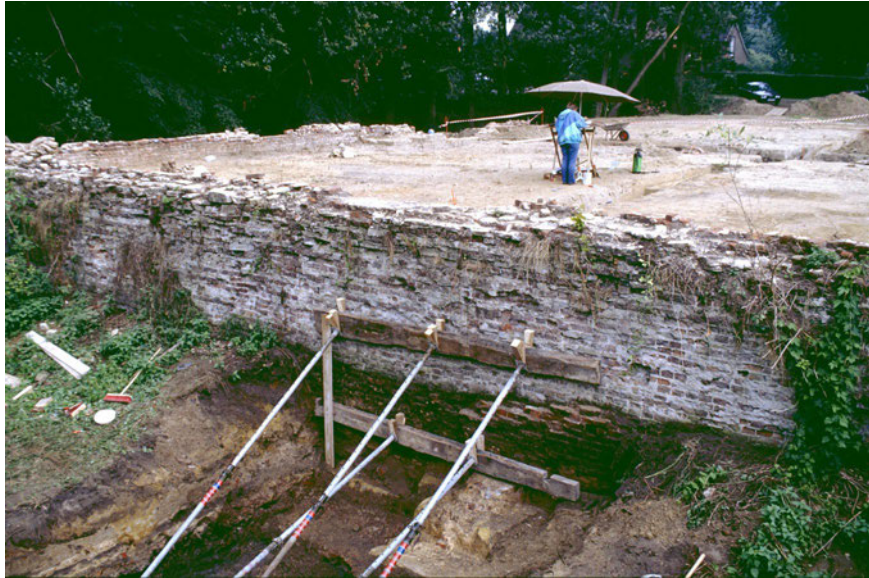
Abb. 46. Greven (Kr. Steinfurt). Burg Schöneflieth. Die Mantelmauern der Burg drohten auseinanderzubrechen (Foto: LWL-Archäologie für Westfalen).
