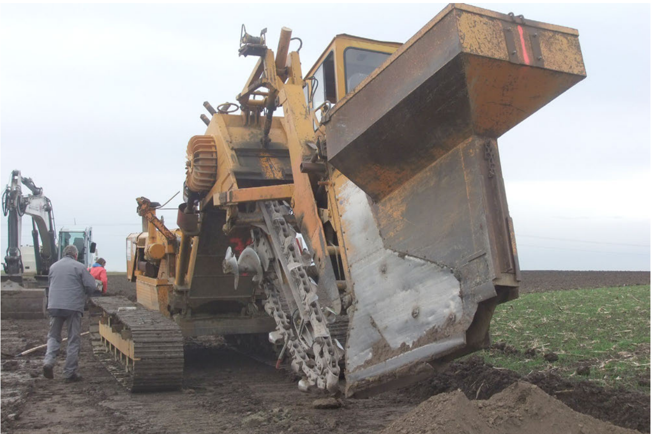
Abb. 3. Ein Kabelpflug (Foto: M. Nadler, BLfD).
