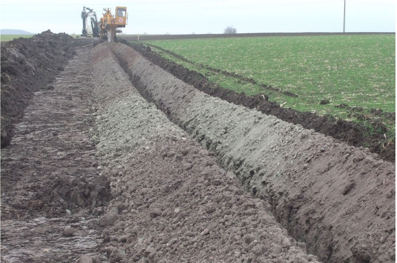
Abb. 2. Für das Verlegen dieser Wasserleitung in Mittelfranken mithilfe eines Kabelpflugs ist ein Humusabtrag erforderlich. Auch bei dieser Methode kann eine bodendenkmalpflegerische Maßnahme erforderlich werden (Foto: M. Nadler, BLfD).
