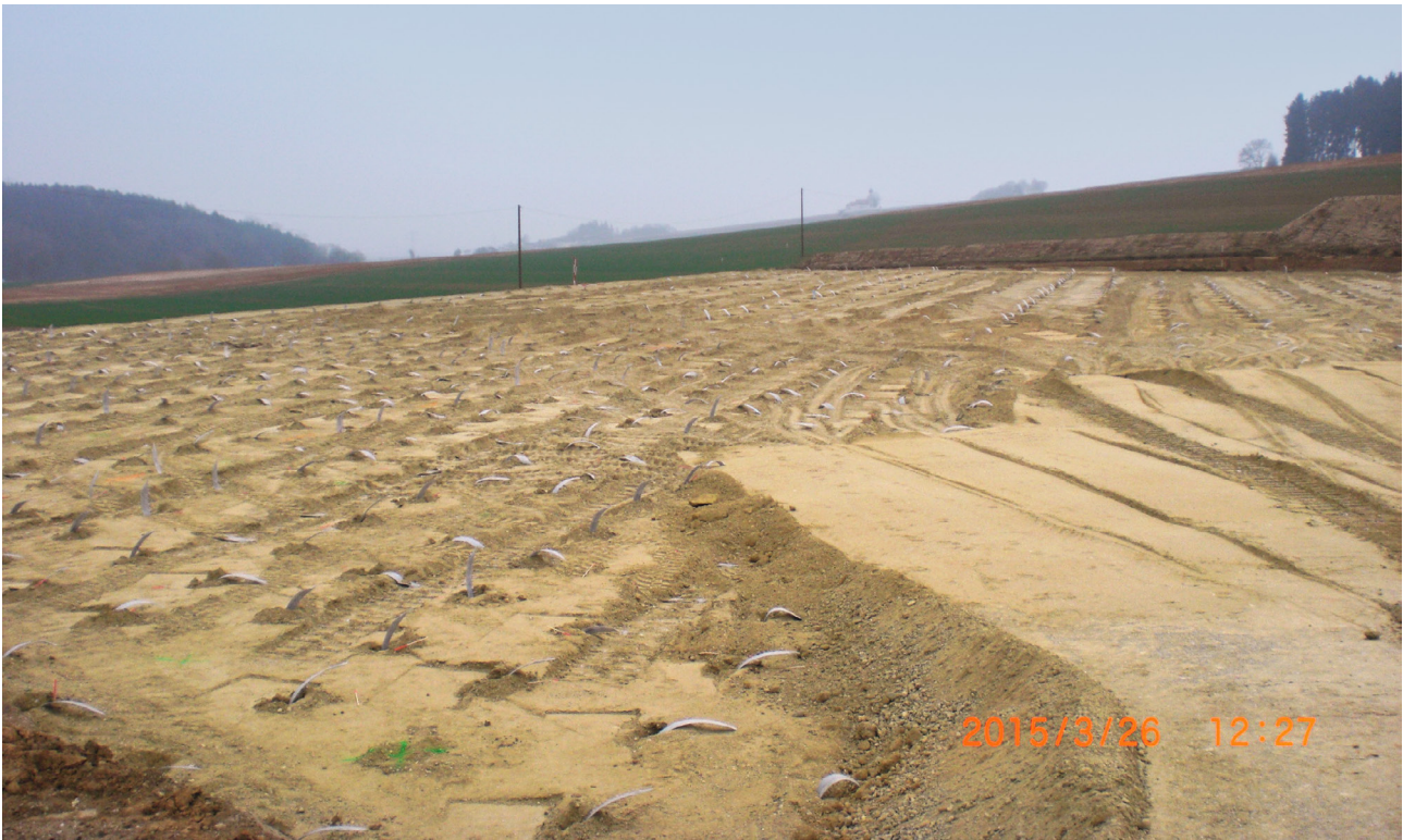
Abb. 21. Essenbach (Lkr. Landshut). Dichte der punktuellen Störungen durch eine Bändchendrainage im Bereich der B15 neu (Foto: A. Appelt, Autobahndirektion Südbayern).
