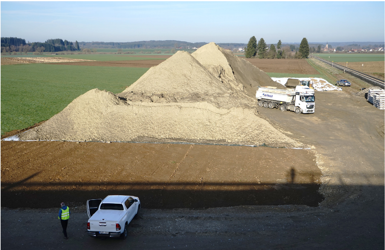
Abb. 25. Geltendorf (Lkr. Landsberg am Lech). Lagerung von Bahnschottern. Temporäre Überdeckung hat zu signifikanten Zerstörungen der Denkmäler geführt (Foto: A. Walgenbach, BLfD).
