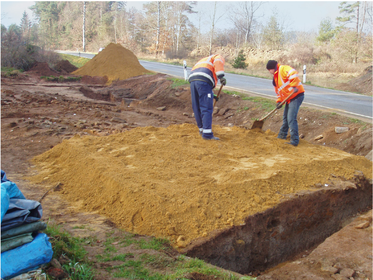
Abb. 19. Weiltingen (Lkr. Ansbach). Überdeckung der Limesmauer nach der Dokumentation (Foto: B. Pargmann, BLFD).
