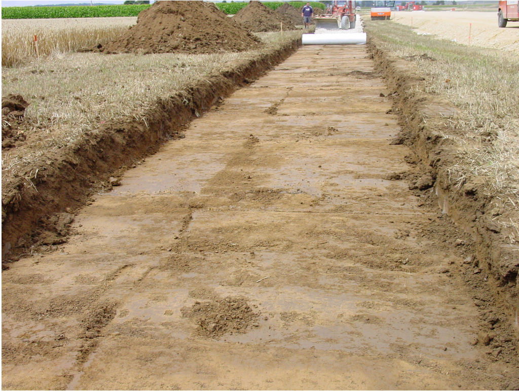
Abb. 28. Konservatorische Überdeckung auf dem Oberboden im Bereich der Bundesstraße 25 Nordumfahrung Nördlingen (Lkr. Donau-Ries); im Bereich des Radweges wurde das Geovlies nach dem Bodenabtrag verlegt (Foto: St. Berg, BLFD).
