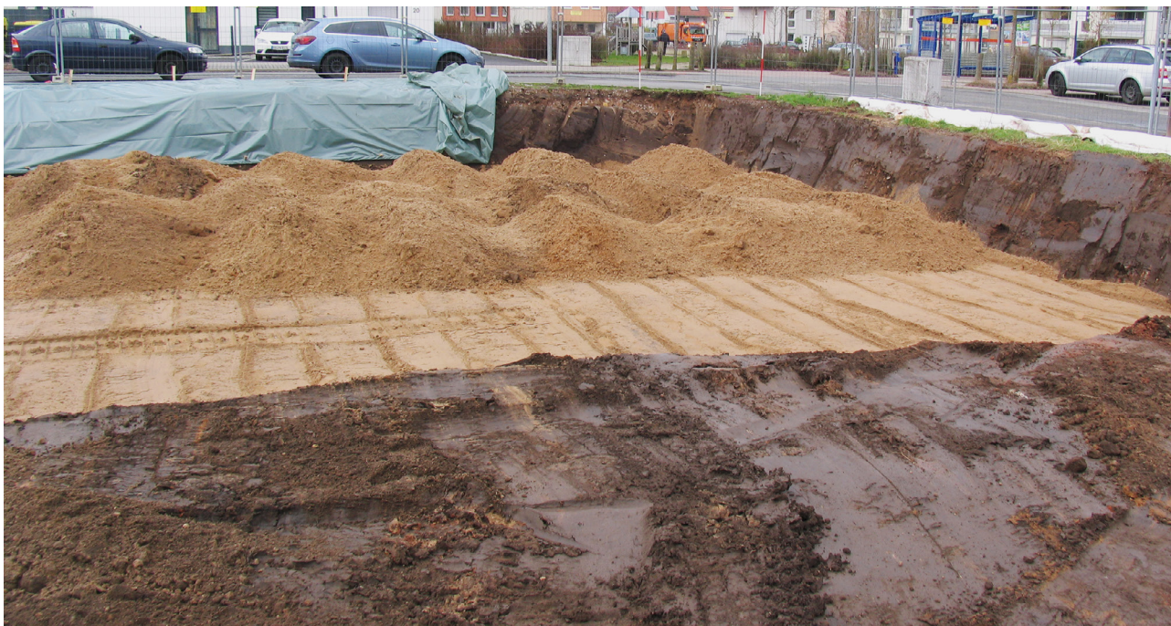
Abb. 35. Groß-Gerau (Lkr. Groß-Gerau). Überdeckung der archäologischen Befunde im römischen vicus während der Ausführung (Foto: R. Klausmann, hA).
