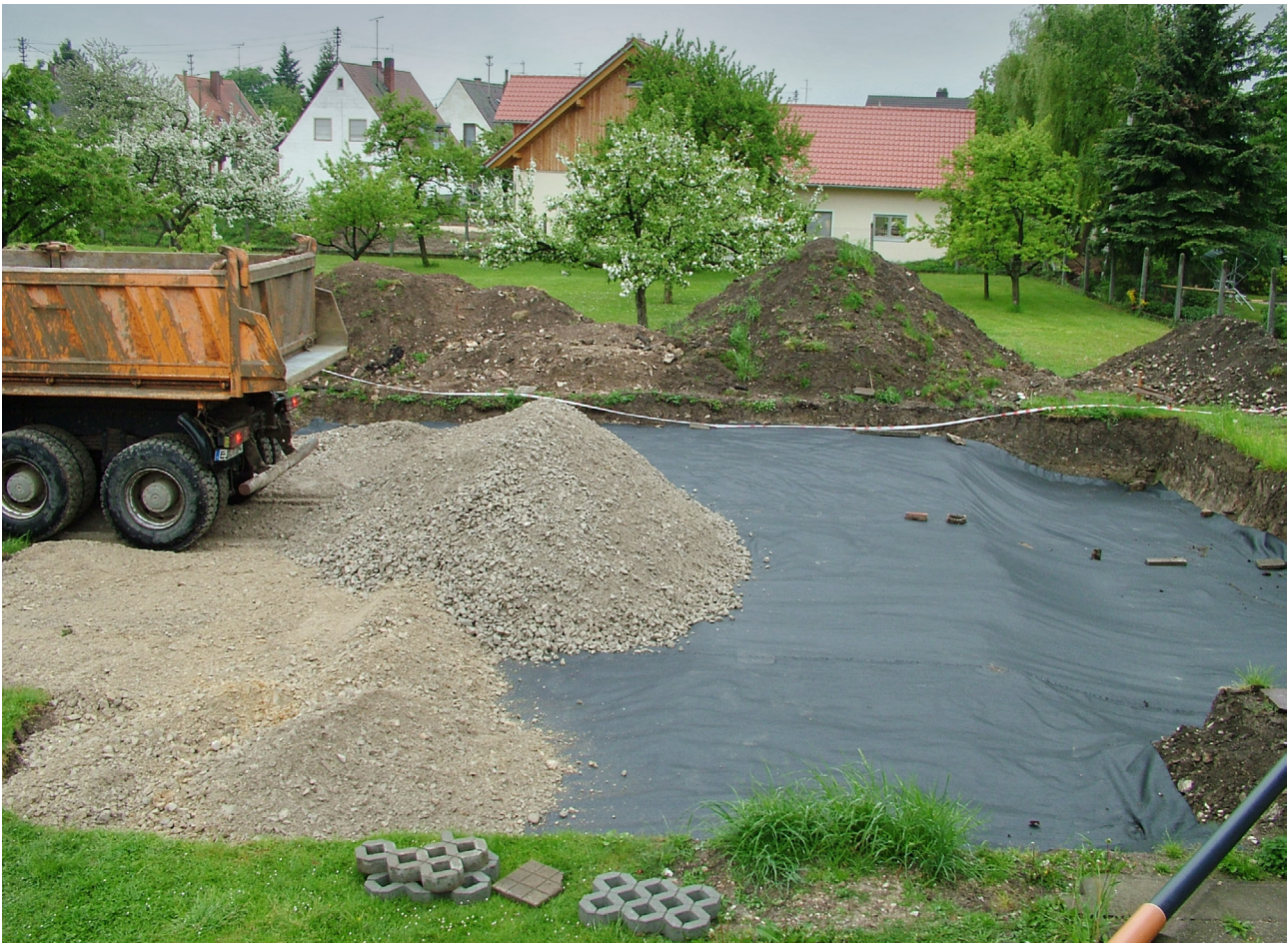
Abb. 26. Kösching (Lkr. Eichstätt). Ein Geovlies wurde verlegt, nachdem der Humus maschinell entfernt worden war. Auf dem Vlies wurde der Schotter verteilt (Foto: Bildarchiv, BLfD).
