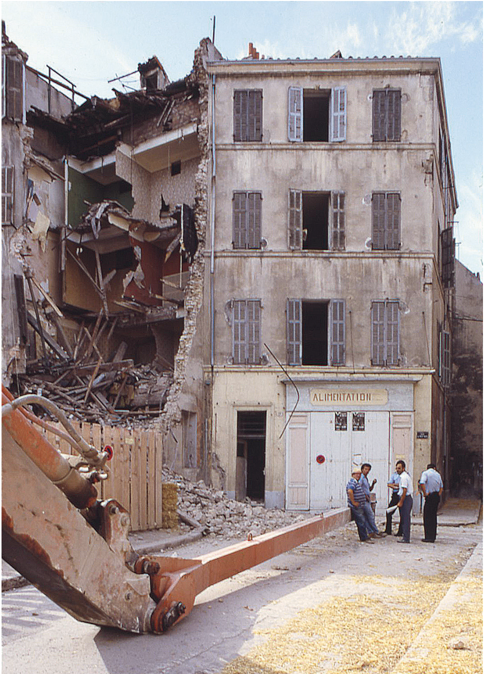
Abb. 4: Sanierung des Häuserblocks in der Rue des Pistoles, Juli 1988. Archives de Marseille, 1063W1521_8807073.
