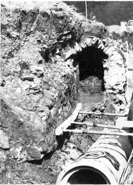
Abb. 20: Die römische Ruwerwasserleitung nach Trier wurde 1974 beim Ausbau der Ruwertalstraße (K 57) und der Verlegung einer Sammelabwasserleitung bei Waldrach mehrfach angeschnitten. Eine regelmäßige Überwachung der Baustellen ermöglichte den Verlauf der antiken Trinkwasserleitung Triers festzulegen.
