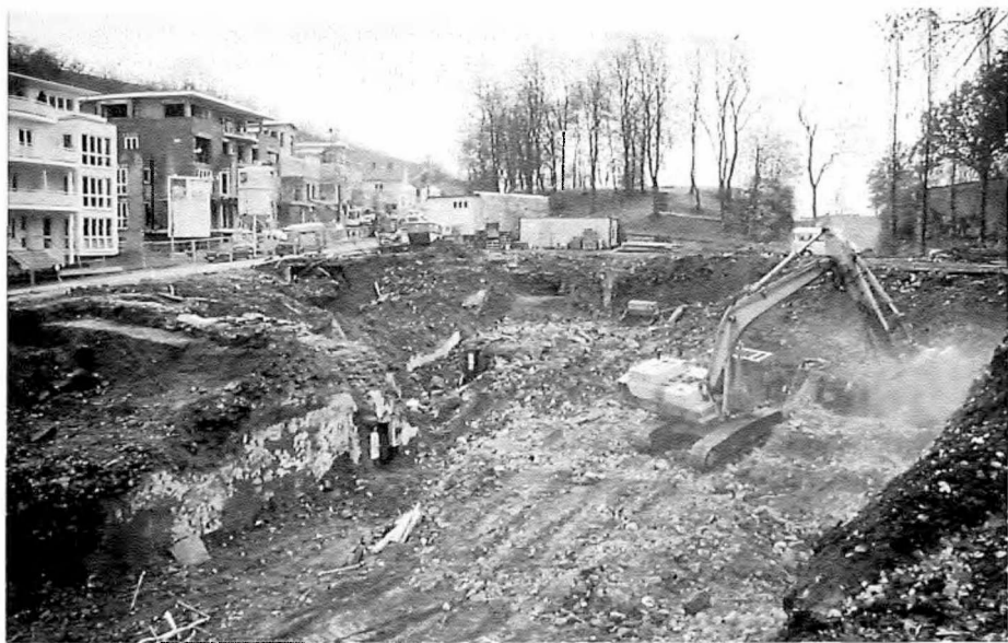
Abb. 1 Ausgraben vor dem Abbruchbagger: Bauabschnitt III der Ausgrabung auf dem ehemaligen Löwenbrauerei - Gelände am Nordausgang des Amphitheaters.
