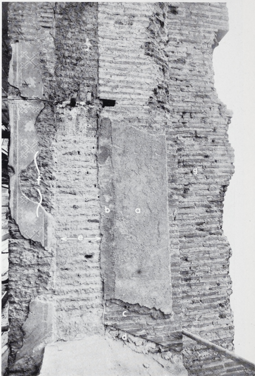
Trier, Aula Palatina. Westliche Längswand, zweites Fenster von Süden, untere Reihe, südliche Fensterleibung.
