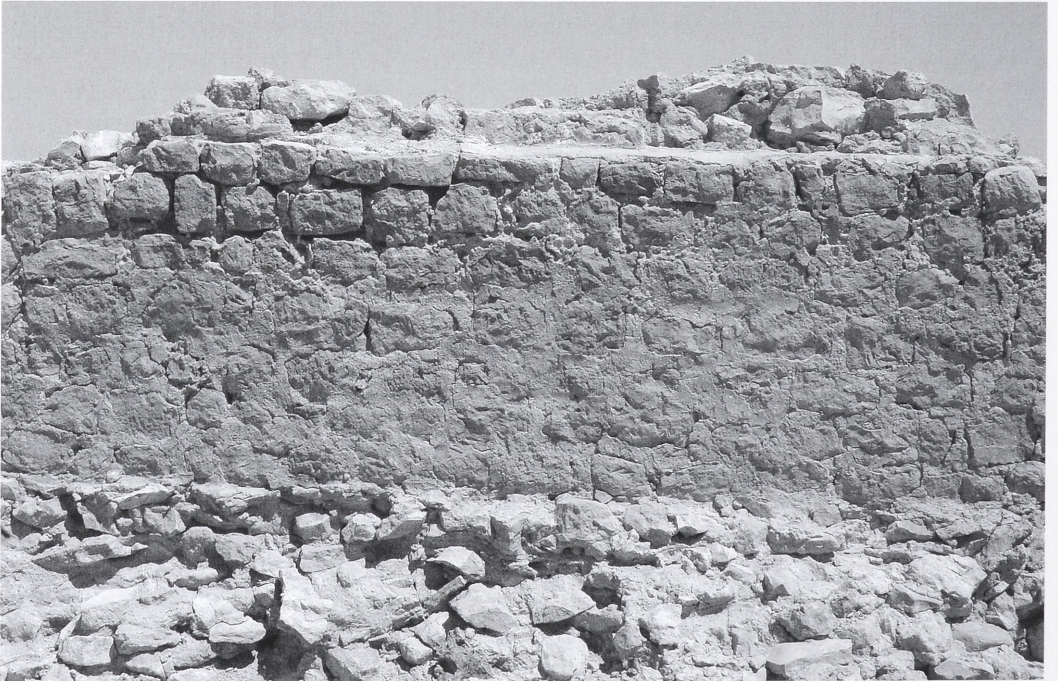
Abb. 14. Gasr Wames im oberen Wadi Sofeggin. Burgartige Kleinfestung. Ausschnitt der nördlichen Brüstungsmauer von innen mit zugesetzten Scharten, unten abgebrochener Caementicium-Boden des Flachdachs.
