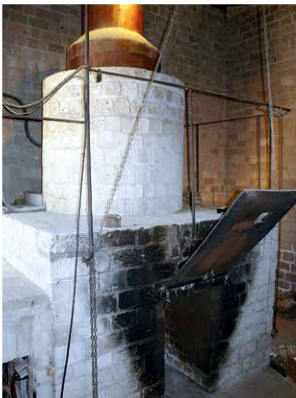
Abb. 11. Archäologischer Park Xanten (Kr. Wesel). Herbergsthermen, praefurnium mit aufgesetztem Warmwasserboiler, der zur Wärmeisolierung großteils mit Ziegeln ummauert ist (Nachbau nach der Villa von Bosco Reale). Die Klappe vor der Feuerungsöffnung bei dieser Rekonstruktion ist für Hypokaustheizungen bisher nicht nachgewiesen und feuerungstechnisch für Hypokaustheizungen falsch 61 .
