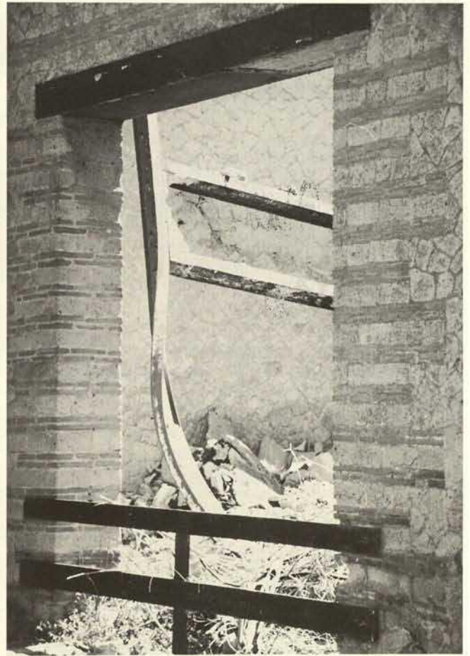
Casa dell'atrio a mosaico, salon facing the sea, collapsed modern ceiling
