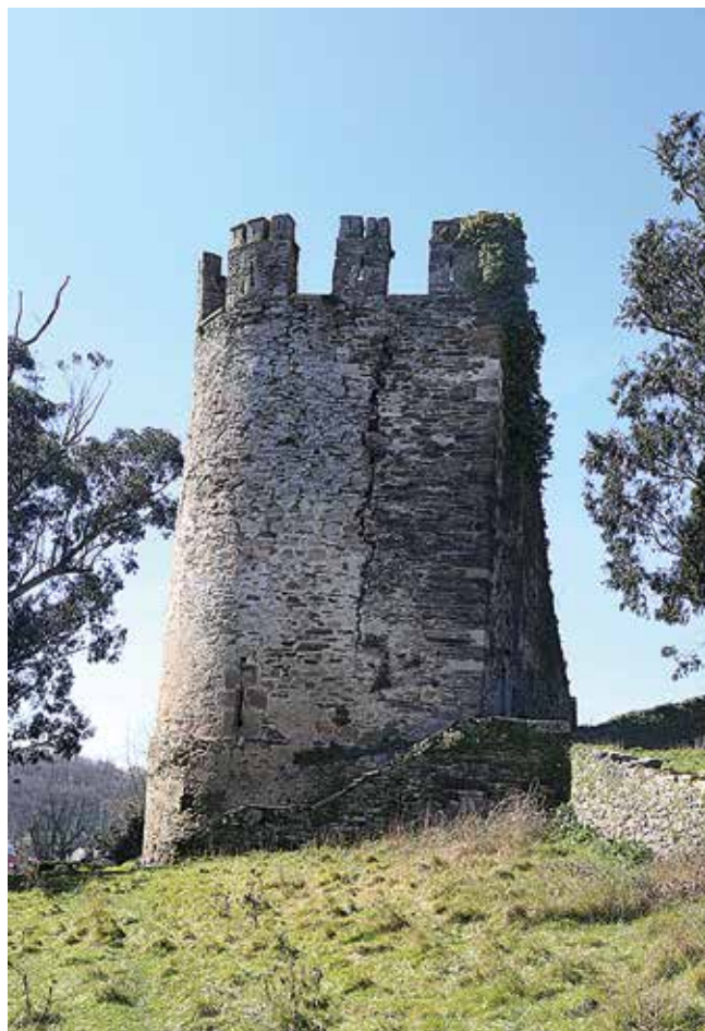
Torre de la fortaleza de Sarria, observese la gran grieta y el desplome del muro
