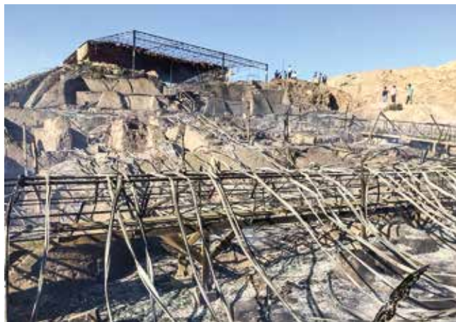
Fig. 3. Afectación de la estructura peatonal instalada para la visita turística (Fuente: www.andina.pe , 2019)
