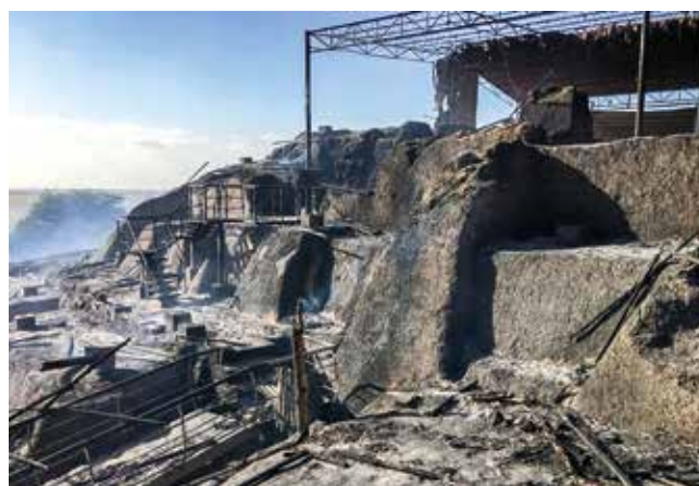
Fig. 2: Afectación de la cobertura metálica donde están expuestas pinturas murales prehispánicas (Fuente: www.andina.pe , 2019)
