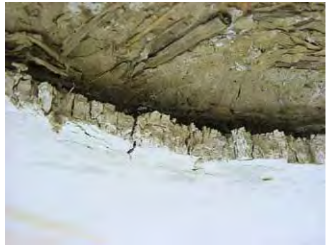
Abb. 16: Ablösung der Kalkputzschicht vom Lehmuntergrund
