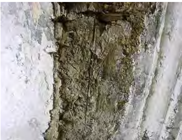
Abb. 5: Fehlstelle in der Stuckatur, Vorrizung im Lehmuntergrund
