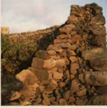
Abb. 8 Typischer Verlauf der von der Mauerkrone ausgehenden trichterförmigen Mauerausbrechungen
