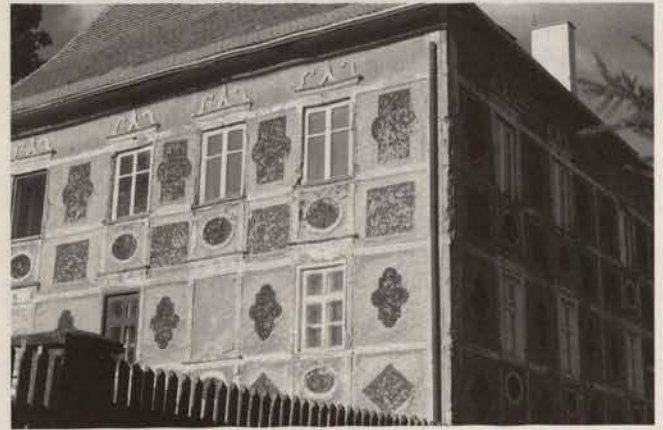
Abb. 6. Farrach, Stmk., Schlossfassaden um 1600: weiß gekalkte Bänderung, Naturputzflächen und mit Schlacken inkrustierte Felder, Zustand 1987
