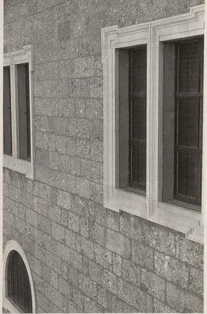
Abb. 1. Salzburg, Dom, steinsichtige Südfassade des Langhauses: Konglomeratquadermauer mit Fensterprofilen aus Untersberger Forellenmarmor, von Santino Solari 1612–1628
