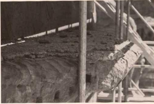
Abb. 15. Grab 636, mehrfache Mörtellage auf dem Hauptgesims Fig. 15. Tomb 636, mortar layers on the main cornice
