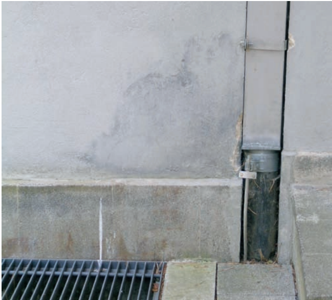
Abb. 3. Dessau, Meisterhaushälfte Muche: Schäden durch Dauerfeuchte im Bereich eines lecken Fallrohrs.
