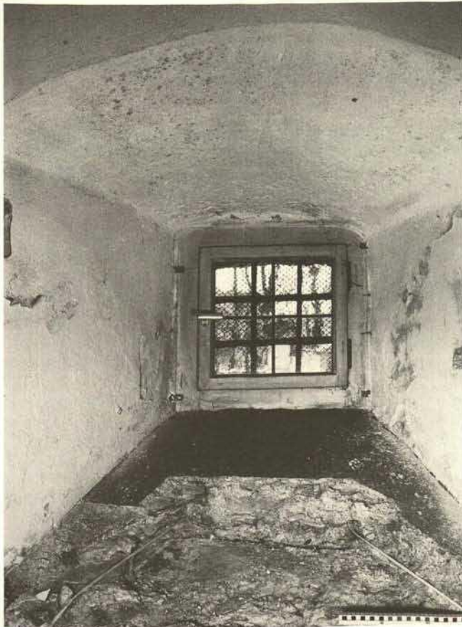
Abb. 143. Regensburg, St. Emmeram, Ringkrypta, nördlicher Ringgang, freigelegte Reste einer bauzeitlichen Fensterlaibung mit Fassungsbeleg im Bereich der Sohlbank.
