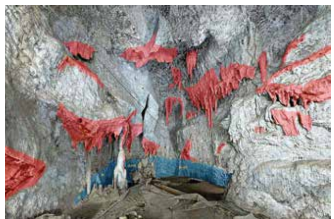
Abb. 11: Schadenskartierung im Bereich „Königssitz“. Rot: akut absturzgefährdete Drahtputzschale, Blau: R: rückseitig eindringende Nässe, A: aufsteigende Nässe
