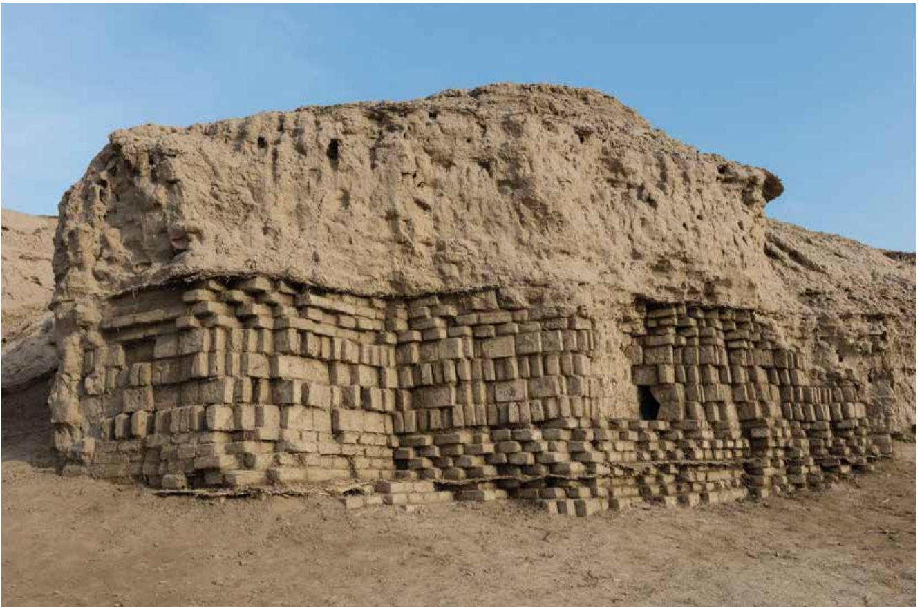
Abb. 9: Uruk. Die Westecke des Kerns der Eanna-Zikkurrat (21. Jahrhundert v. Chr.) wurde mit modernen Lehmsteinen untermauert, um einen drohenden Abgang zu vermeiden (Foto: DAI, Irmgard Wagner)
