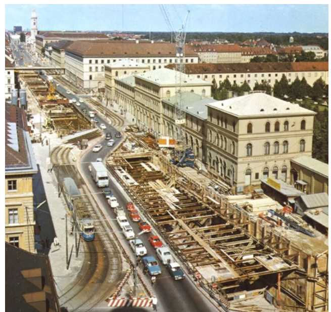
Abb. 4: Blick vom Odeonsplatz in die offene Baustelle der Nord-Süd-U-Bahnlinie U6 entlang der Ludwigstrasse, München. Foto: Alfred Haase, 1966
