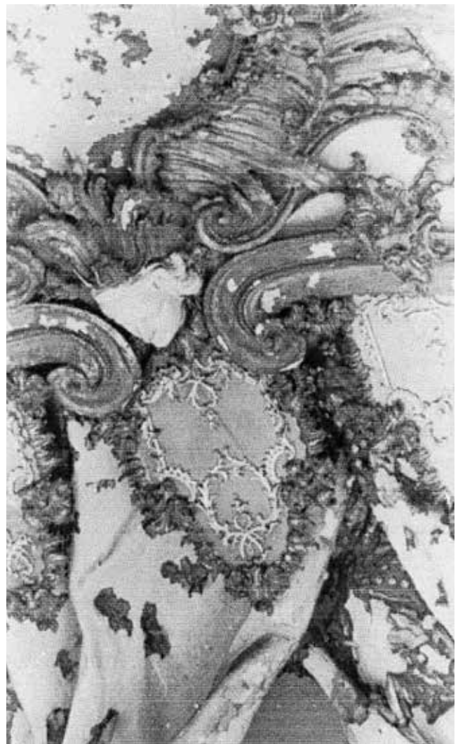
Abb. 4a Residenz Würzburg, Kaisersaal, Detail der beschädigten Stuckdekoration nach den Kriegszerstörungen 1945 (Foto Bayerische Schlösserverwaltung)
