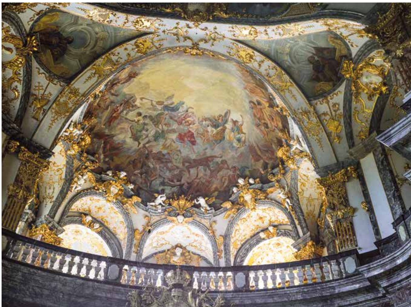
Abb. 9a Hofkirche: Westliche Gewölbekuppel mit „Engelssturz“, Erhaltungszustand 1978 mit Übermalungen und Ergänzungen von Karl Körner; ausgeführt 1959–62 (Bildarchiv Foto Marburg, Bilddatei-Nr. fmc380956, Aufn.-Datum: 1978)
