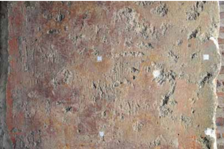
Abb. 1-9: Ausschnitt aus der südlichen Fensterlaibung W6, Zustand 2009
