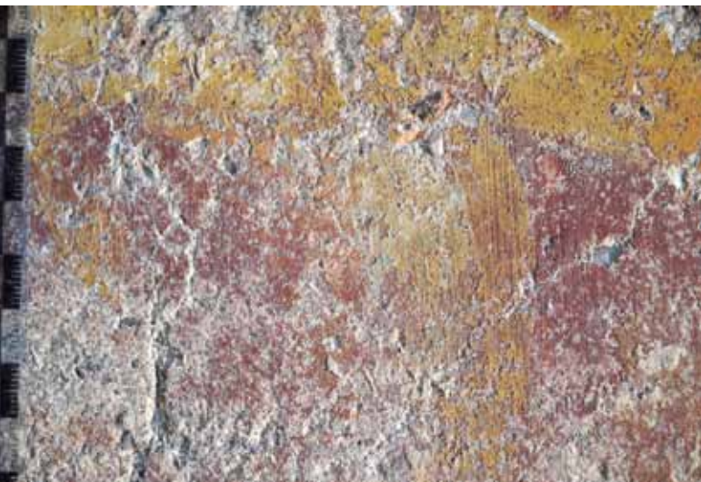
Abb. 1-10: Detailansicht der Maleroberfläche, südliche Fensterlaibung W6, Zustand 2009
