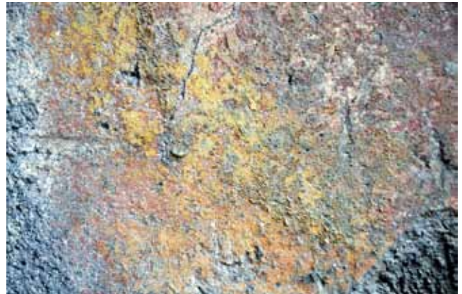
Abb. 4-39: Vergilbter und in sich gerissener Schutzüberzug der 1950er Jahre auf Fensterachse N11
