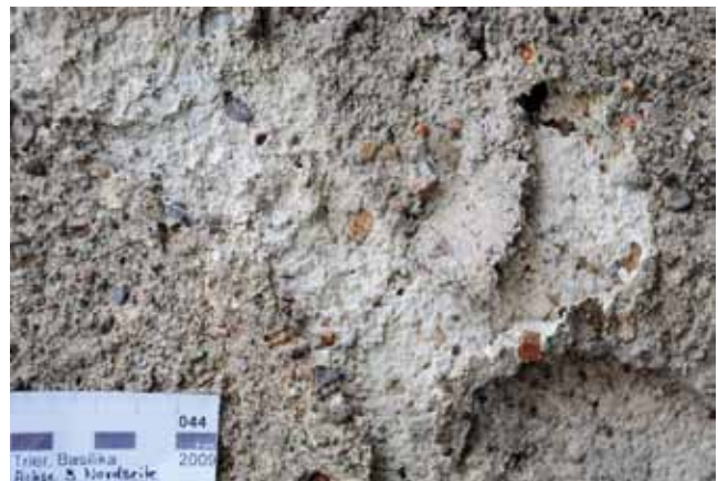
Abb. 7-7: Strukturell entfestigte Putzpartie mit Schalenbildung
