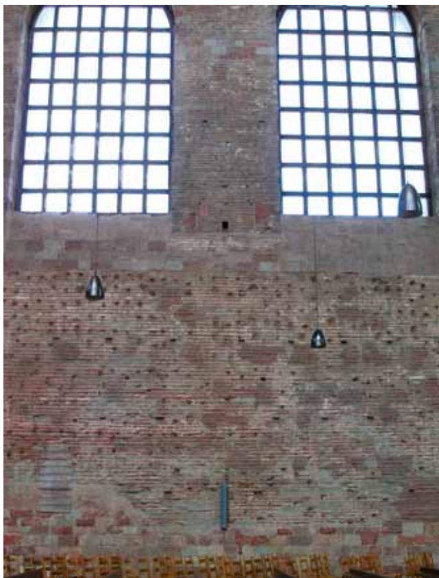
Abb. 8-7: Befestigungslöcher der ehemaligen Marmorinkrustation im Inneren der Konstantinbasilika auf der Westwand
