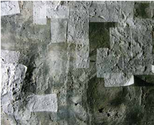
Abb. 10-11a: Detail des Musterfeldes der Diplomarbeit H. Meschke; Kopfdarstellung; Vorzustand mit Notsicherungen 2008; Streiflichtaufnahme; Bildhöhe: ca. 30 cm
