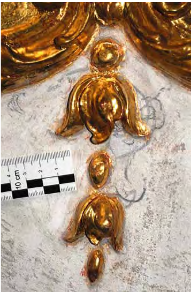
Abb. 4: Stuckdekoration mit freigelegter Vorzeichnung auf dem Wand- und Gewölbeputz (Foto: M. Staschull, 2010)
