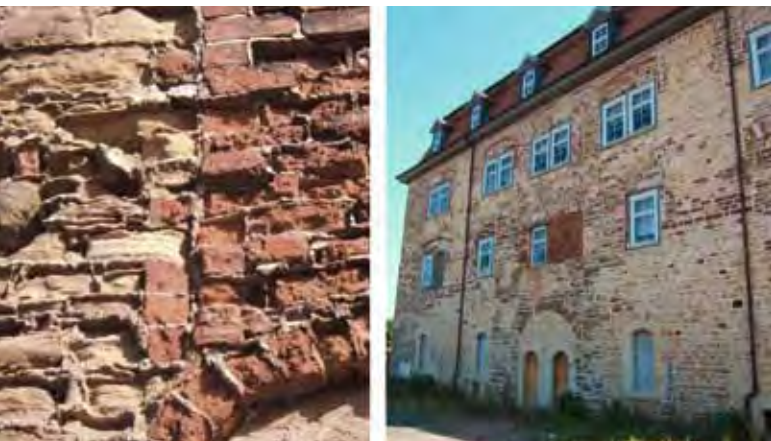
Abb. 7: Heringen a. d. Helme, Schloss, links stark verwittertes Sandstein- und Ziegelmauerwerk mit witterungsresistenten Setzmörteln aus Hochbrandgips, rechts die gleiche Fassade nach der Instandsetzung mit modernem Gipsmörtel
