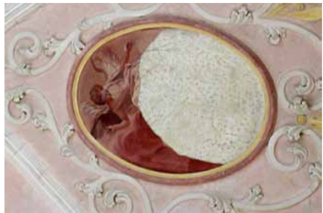
Abb. 3: Pfarrkirche Willprechtzell, die Medaillons und die umrahmenden Stuckierungen wurden in einer zweiten Ausstattungsphase eingefügt. Die Stuckierung der Gewölbegrade ist bauzeitlich. Das Spantengewölbe ist durch zahlreiche Schäden und Zerstörungen der Dachwerke großflächig deformiert.
