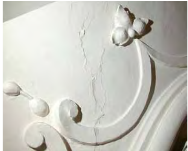
Abb. 2: Fürstenzell, Klosterkirche, aufstehende Farbschichten im Scheitel des Chorbogens auf der Seite des Langhauses; die Risse sind wohl bereits bauzeitlich bei der Ausschalung des Gewölbes entstanden; die Rissöffnungsweite folgt der jahreszeitlichen Beanspruchung und kann nicht dauerhaft geschlossen werden.
