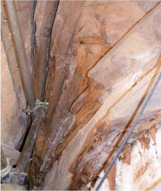
Abb. 13: München, Berg am Laim, Pfarrkirche St. Michael, zerstörtes Spantengewölbe, Seitenansicht der Spanten in der Gewölbetrompe Süd-West über dem Zentralraum
