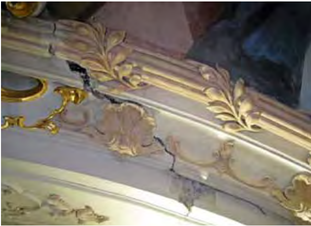
Abb. 23. Schäftlarn, Klosterkirche, Relativverformung zwischen mittlerer Gewölbekuppel (Hauptraum) und westlichem Gurtbogen
