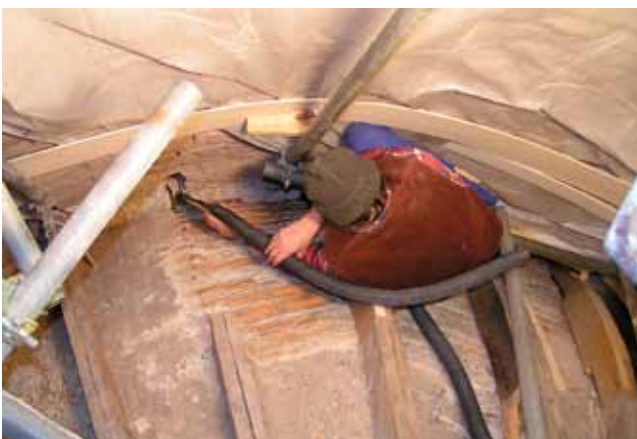
Abb. 15: München, Berg am Laim, Pfarrkirche St. Michael, zerstörtes Spantengewölbe, Blick von oben in die Gewölbetrompe Süd-West über dem Zentralraum; im rechten Bildfeld die bereits reparierten Spanten aus Abb. 13
