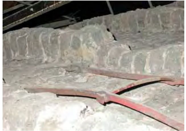
Abb. 37: Würzburg, Residenz, Draufsicht auf das Gewölbe über dem Treppenhaus; die eiserne Verankerung gehört zu den Kreuzstreben der Dachbinder des im 2. Weltkrieg zerstörten Dachwerks.
