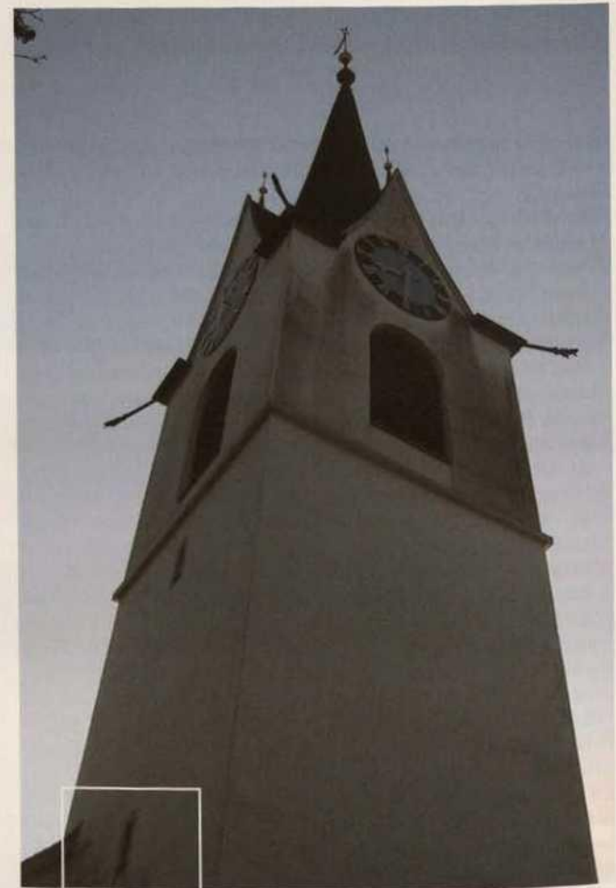
Abb. 8b. Nord- (links) und Westfassade eines Kirchturms, welcher knapp 5 Jahre zuvor mit „veredelter Kalkfarbe“ gestrichen worden war: Dunkle Verfärbungen durch biologischen Befall (20.3.2003; gerahmter Ausschnitt s. Abb. 8a).
