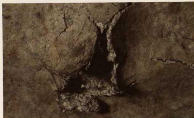
Abb. 11. Quedlinburg, Stiftskirche St. Servatius, Krypta: Sich ablösender Feinputz mit spannungsreicher Kunststoffbeschichtung.
