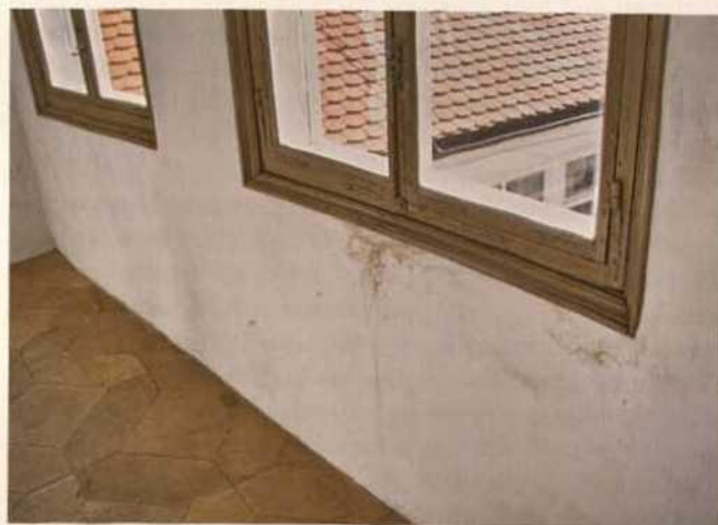
Abb. 6. Nürnberg, Johannisstraße 19, Saal im Dachgeschoss: Feuchtschäden im Bereich restaurierter Fenster (2004).
