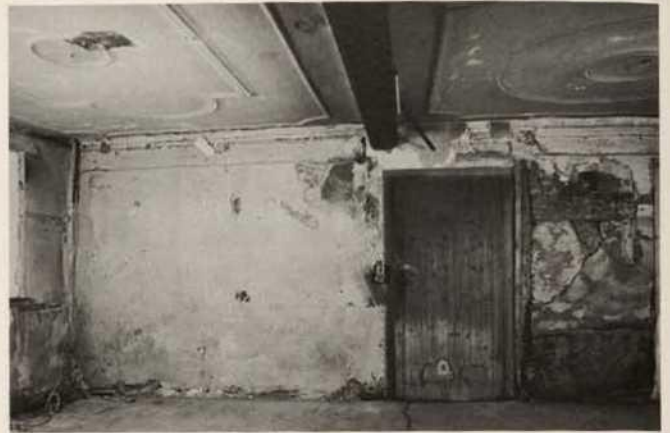
Abb. 19. Kucha, Haus Nr. 18, Mühlengebäude, Erdgeschoss: Stube vor der Instandsetzung (2000).
