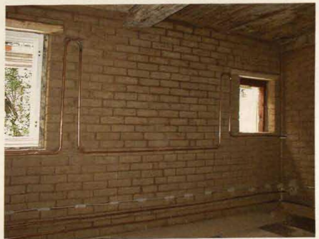
Abb. 24. Kucha, Haus Nr. 18, Mühlengebäude, Obergeschoss: Vormauerung mit Lehmstein vor der Putzausführung, mit aufgelegten Rohrtrassen der Temperierung und Elektroinstallation (2002).
