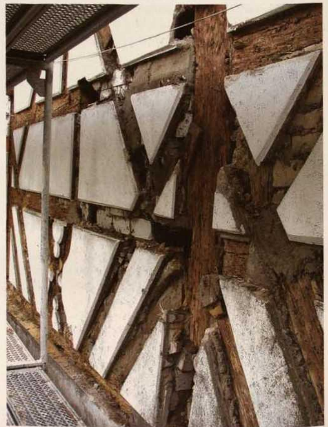
Abb. 20. Kucha, Haus Nr. 18, Mühlengebäude: Schäden an der Fachwerkfassade vor Abnahme der zementären Gefachputze (2002).
