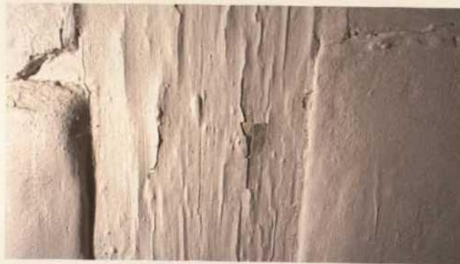
Abb. 13. Fürth, Königstraße 89, erstes Obergeschoss: Farbabhebungen an Holzflächen (Fachwerk und Balken-Bohlen-Decken) aufgrund nicht abgestimmter Eingriffe in die Regeltechnik des Heizsystems (2004).
