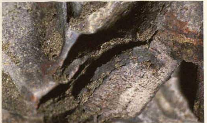
Abb. 6. Schwäbisch Gmünd, Heilig-Kreuz-Münster, Südportal, Detail: Schadensbild.
