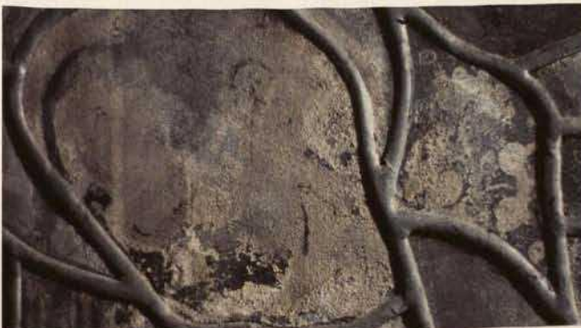
Abb. 3. Nürnberg, St. Sebald, Fenster nIV (sog. Fürer-Fenster), Detail: Nachwachsen der Glaskorrosion infolge der Kondenswasserbelastung.
