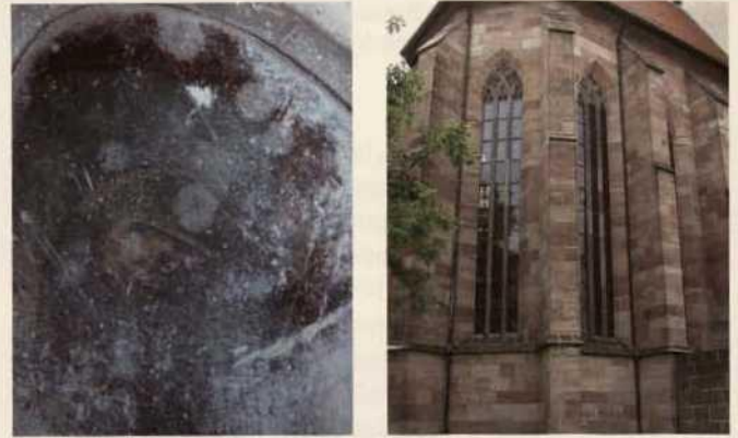
Abb. 7a-b. Nürnberg, Frauenkirche: Glaskorrosion durch Schimmelpilze an sehr widerstandsfähigen Renaissance-Gläsern (a) und Einbau einer Schutzverglasung mit Isolierglas (b).
