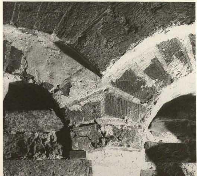
Abb. 3. Asbach, Lkr. Passau, ehem. Benediktinerkloster, Fragment des romanischen Kreuzgangs, 12. Jahrhundert, „Zierschläge“ auf der Backsteinoberfläche (Foto: Pursche)
