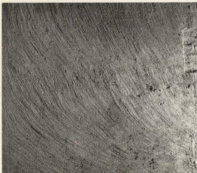
Abb. 7. Augsburg, St. Ulrich und Afra, ehem. Nordfassade Ende 15. Jahrhundert (jetzt östl. hinter der „Schneckenkapelle“), fächerförmige Ebnung des Verputzes (Foto: Hanke)
