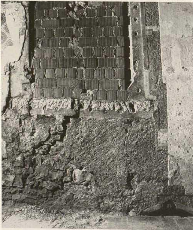
Abb. 10. Regensburg, Hinter der Grieb 8, „Gravenreuther“, südwestlicher Trakt, Nordwand außen, 1. OG, ehem. Doppelarkade, 14. Jahrhundert, untere Hälfte, barocke Überbauung und moderne Zusetzung, teilweise freigelegt, an der rechten Seite des Steingewändes sowie unterhalb der Sohlbank Reste des geglätteten Putzstreifens und rauer Flächenverputz auf Bruchstein (Foto: Pursche)
