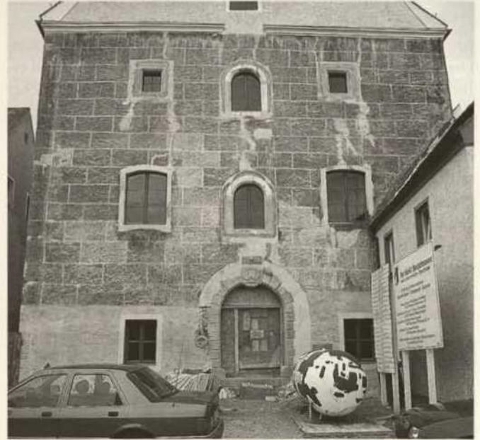
Abb. 17. Beratzhausen, Lkr. Regensburg, ehem. Zehentstadel, bez. 1599, rau mit der Kelle abgezogener Verputz, eingetieft Fugen, Quaderfläche mit Reisigbündel gestupft; während Instandsetzung: Schließen der Risse und erste Reinigungsversuche (Foto: Pursche)
