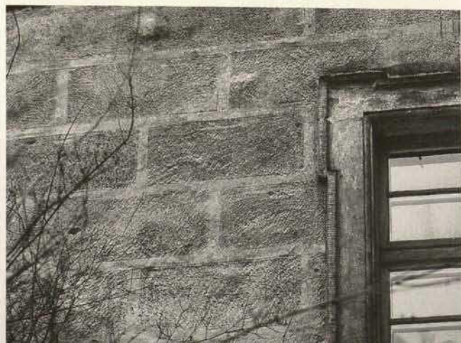
Abb. 15. Thurnau, Lkr. Bamberg, Schloss, 1690, auf angeglättetem Putz Ritzung des Fugensystems, Aufrauung der Quaderbinnenflächen und Stupfen mit einem Nagelbrett, erkennbarer Rapport (Foto: Pursche)
