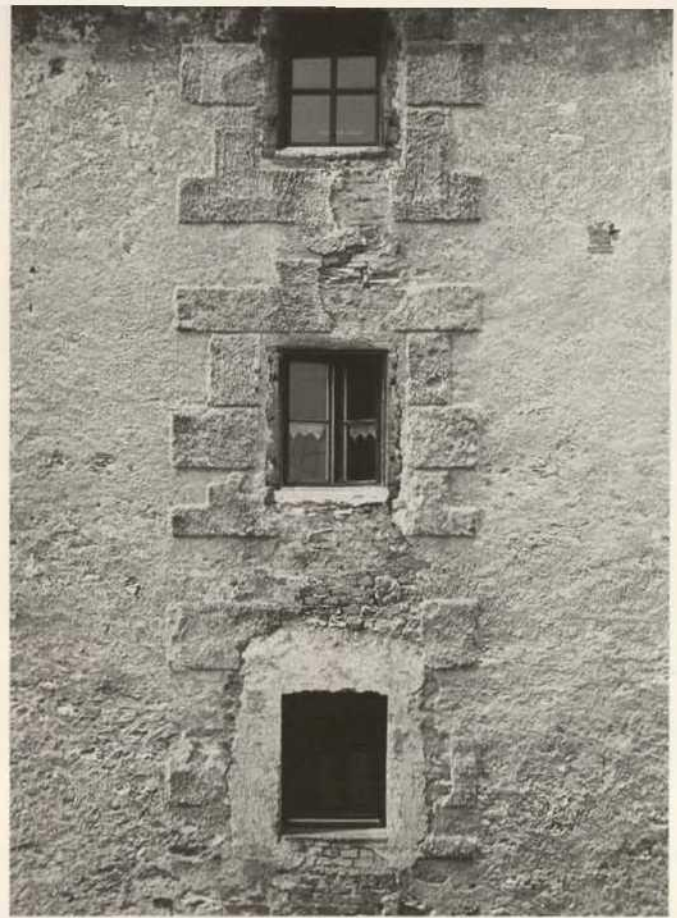
Abb. 11. Höchstädt, ehem. „Getreidekasten“, 1614/22, Stupfputz der rustizierten Fenstereinfassungen (Foto: Röhm)
