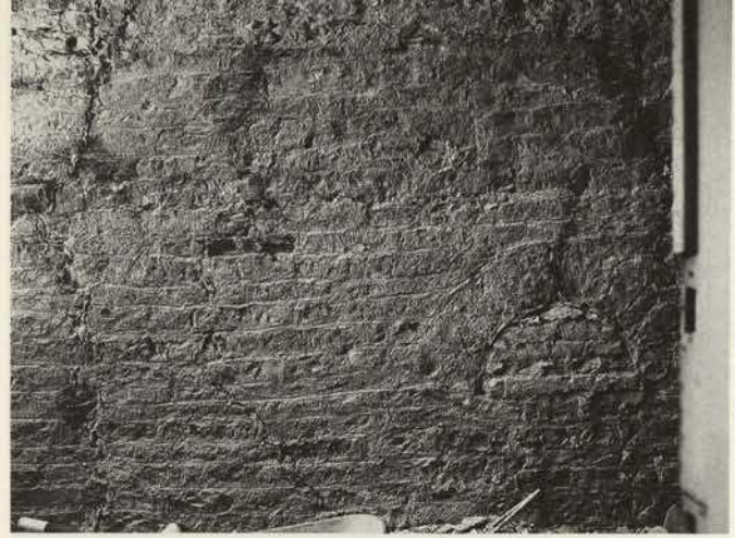
Abb. 1. Regensburg, Hinter der Grieb 10, 1. OG; Außenwand zum Haus Hinter der Grieb 8, 13. Jahrhundert; quaderhaftes romanisches Mauerwerk, mit geritzter Mörtelfuge („Pietra rasa“), am oberen Bildrand gotisches Bruchsteinmauerwerk (Foto: Pursche)
