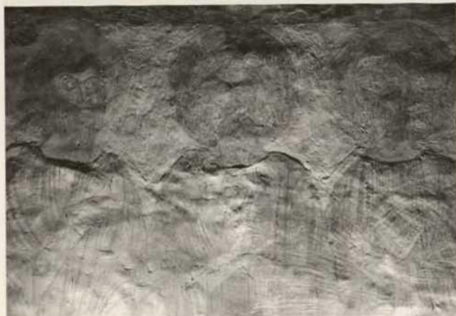
Abb. 12. Knechtsteden, ehem. Prämonstratenserkirche, Westapsis, Fensterzone, Mitte, „Giornata“ (Okt. 1992)
