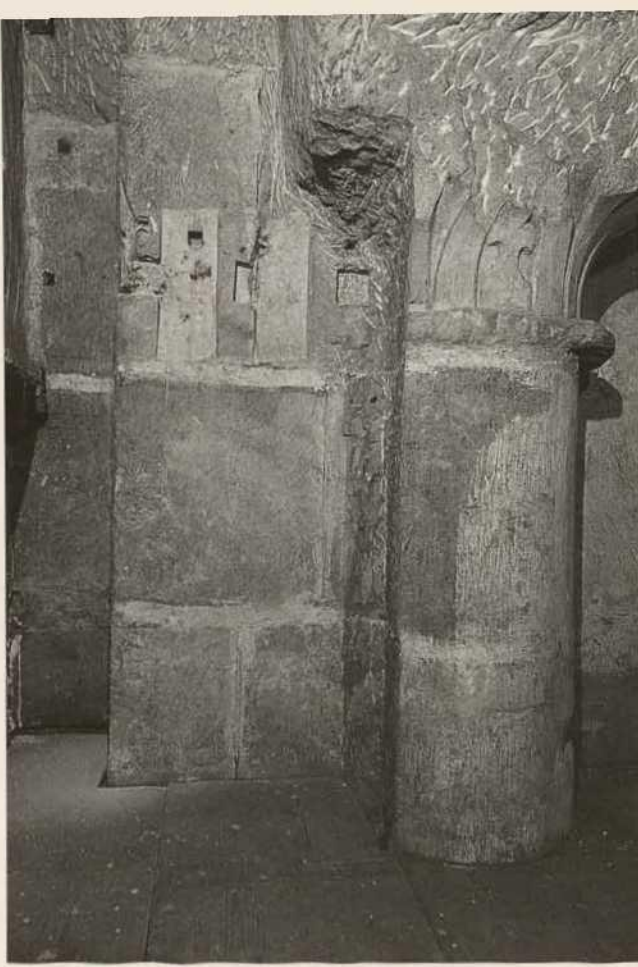
Abb. 17. Ebrach, ehem. Zisterzienserkirche, Mittelschiff, Südseite, 6. Pfeiler (von W), Reste der Fugenmalerei (April 2003)
